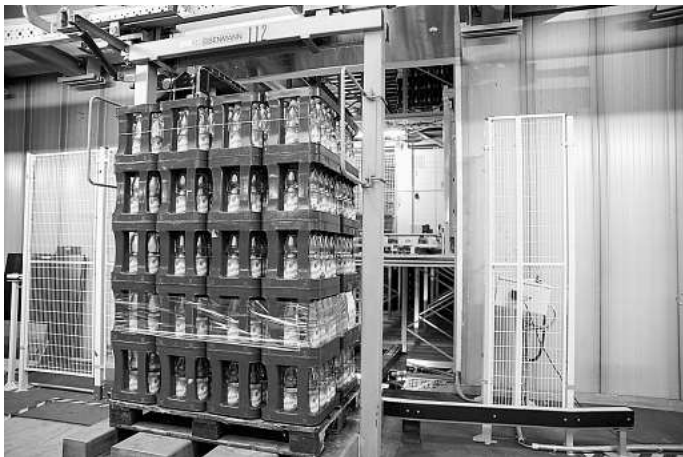
Die Ein- und Auslagerung der Vollgut-Paletten im automatischen Regallager erfolgt im Normalfall durch die bestehende Elektrohängebahn.
