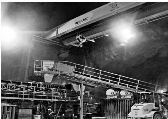
Inbetriebnahme der beiden Zweiträger-Deckenlaufkrane in der Maschinenkaverne.
